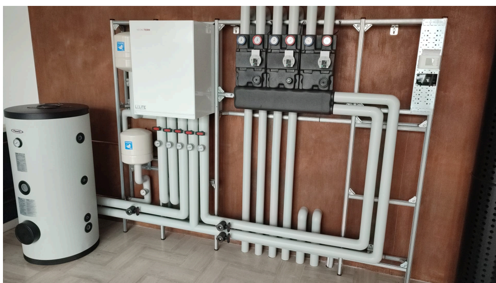
Una centrale termica Sigillo Sicuro completata: accumuli, collettori e tubazioni ben ordinate.
